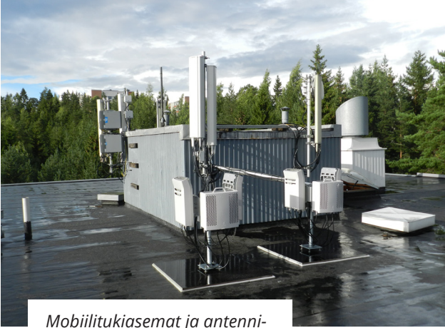
Mobiilitukiasemat ja antennijärjestelmät vaativat apurakenteita kiinteistöjen katoille.
