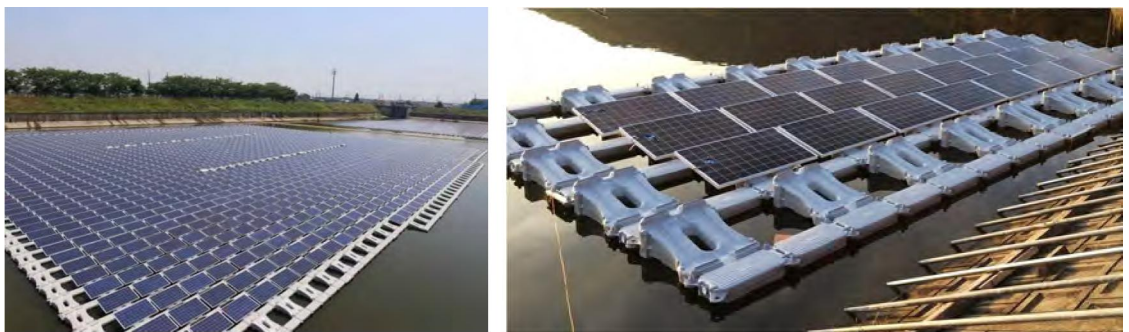
Kuva 2-12 Esimerkkejä kelluville perustuksille asennetuista aurinkopaneeleista. (Kuvat: Ciel&Terre)
