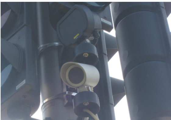
Kuva 33 Tutka- ja vanha infrapunailmaisimain pylvääseen asennettuna
